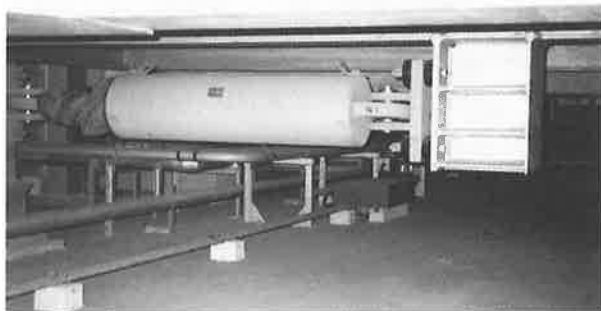
写真-2 オイルダンパー
