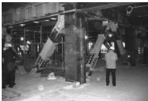
■写真2 ブレーキダンパー設置状況
