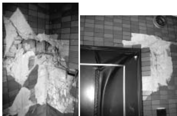
■写真2 福岡県西方沖地震で破損した非構造部材
