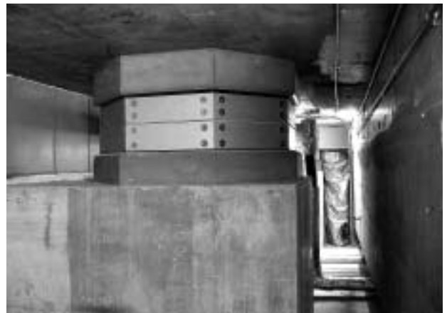
■写真3 耐火被覆された積層ゴム
