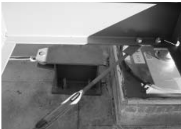
■写真7 オイルダンパー端部(基礎定着部分)
