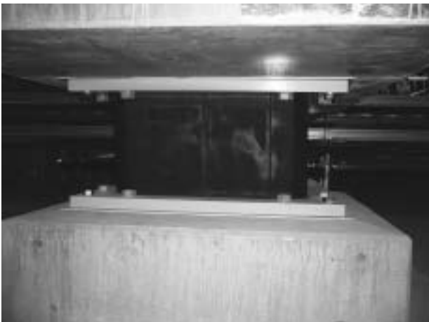
■写真5 積層ゴム
