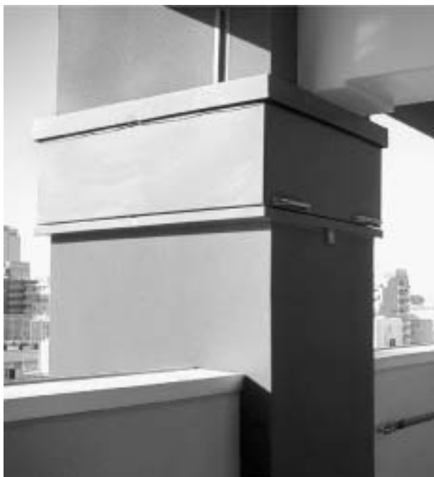
写真3 免震装置耐火パネル
