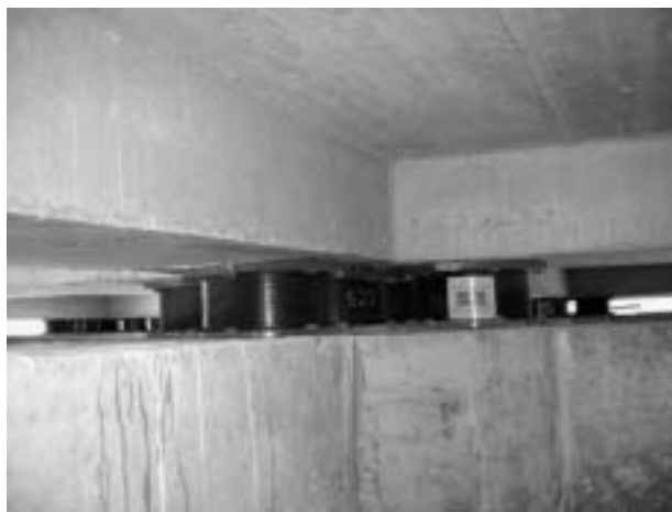
写真8 建物“Our Yard”の免震装置
