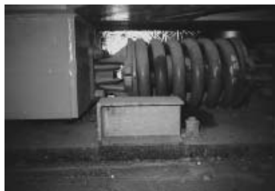
写真3 コイルバネとオイルダンパー
