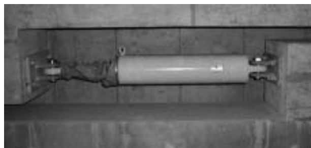
写真2.6 オイルダンパー
