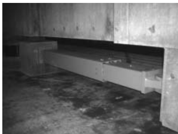
写真2.5 免震用ブレーキダンパー
