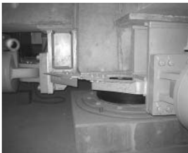
写真5 オイルダンパー取付部
