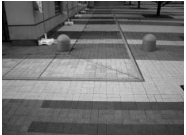
写真6 外部仕様の免震エキスパンションジョイント(EXPJ)
