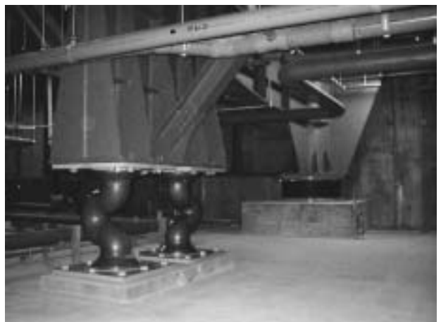
写真7 クールピットの機能も有する免震層
