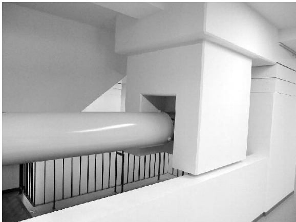
写真4 オイルダンパー設置部
