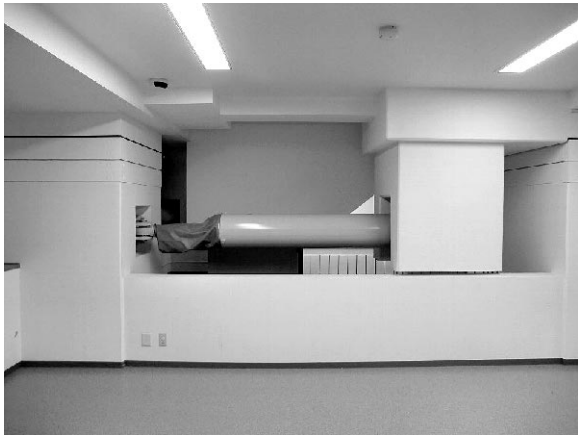
写真3 オイルダンパー
