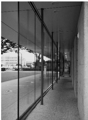
写真9 守衛所のガラス制振
