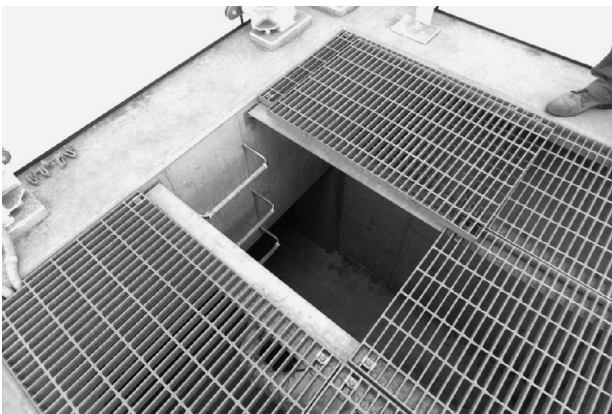
写真4 空気取り入れ口の状況
