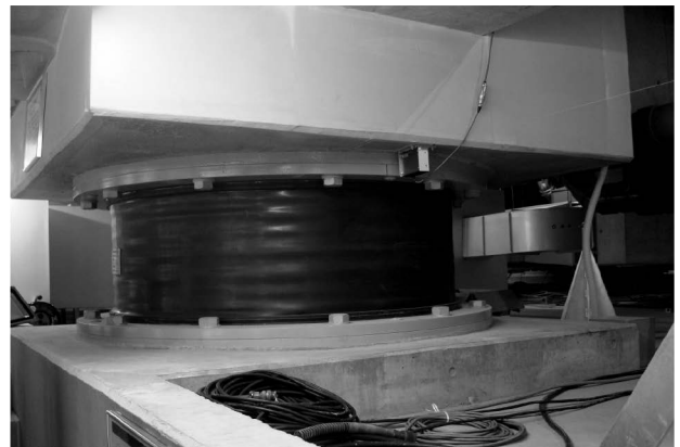
写真6 免震装置 (積層ゴム支承)
