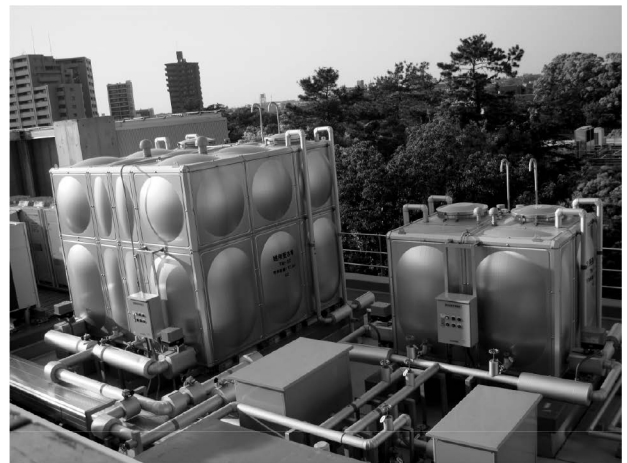
写真5 屋上貯水タンク
