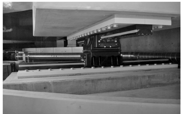
写真7 免震装置 (直動転がり支承)
