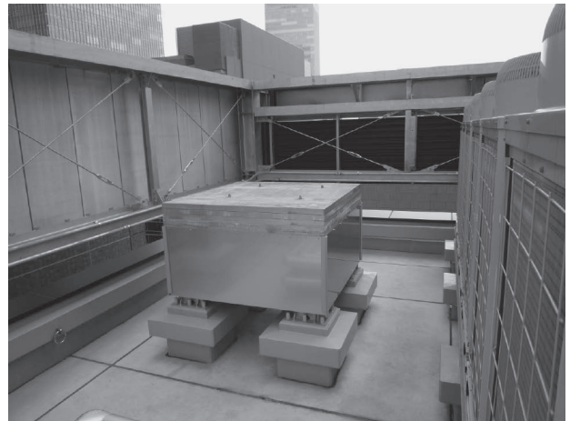
写真2 屋上に設置したTMD
