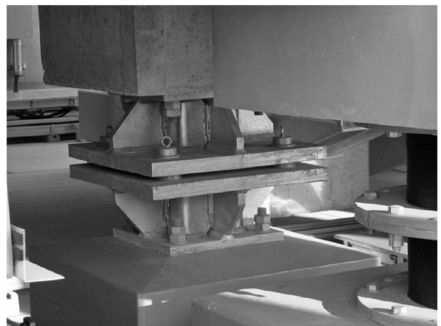
写真11 屋上実験室下免震層 シアピン
