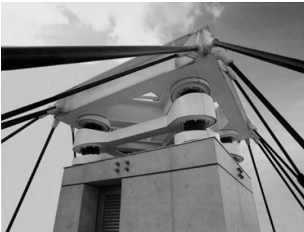
図8 頂部免震装置
