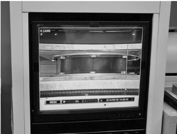
写真10 免震部材監視用モニター
