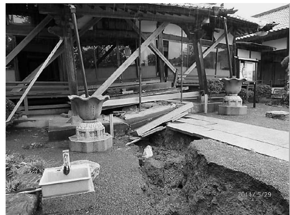
写真1 地表地震断層による伝統木造建物の被害 1)
