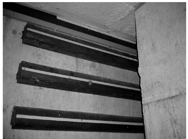
写真8 外周部の衝突緩衝材
