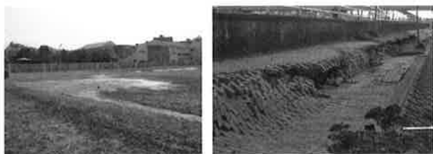
写真1 液状化状況写真、護岸の損傷写真
