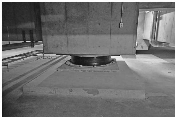
写真7 免震装置（高減衰ゴム系積層ゴム支承）
