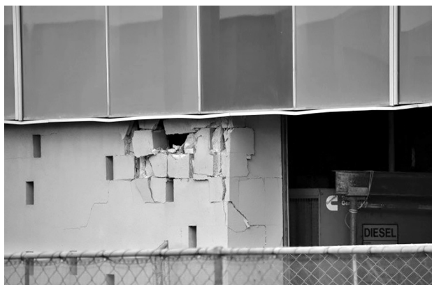
事務所内2次部材の損傷
