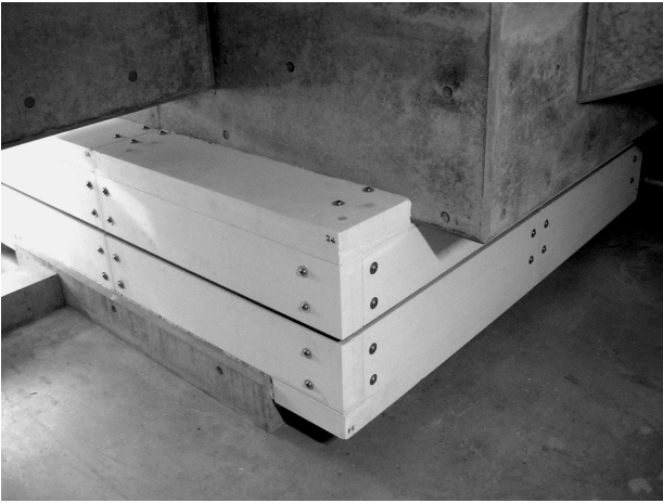
写真10 免震装置（直動転がり支承）
