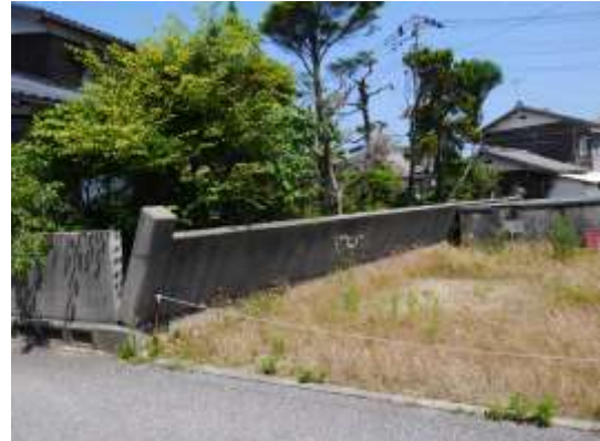
写真 6 ブロック塀の被害（府屋）
