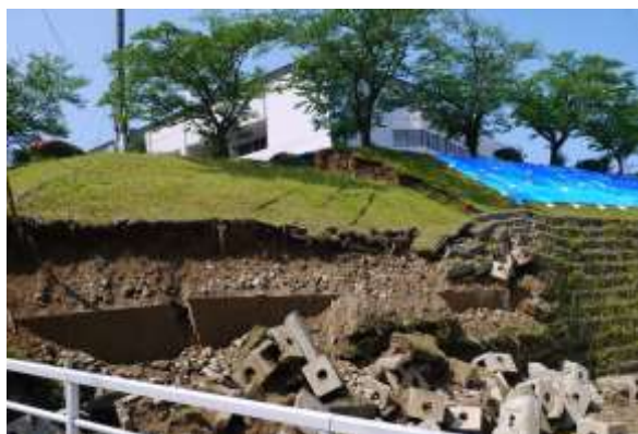
写真3 山北総合体育館 法面崩壊
