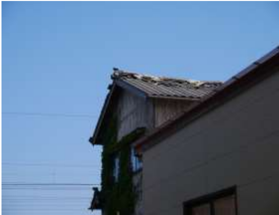
写真 5 屋根瓦の被害（府屋）
