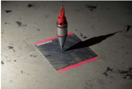
写真 18 下げ振りによる変位計測計
