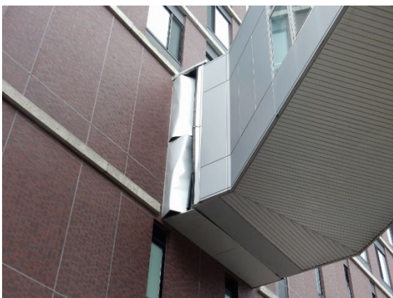
写真4 本館に接続する免震 Exp.J パネルの損傷
